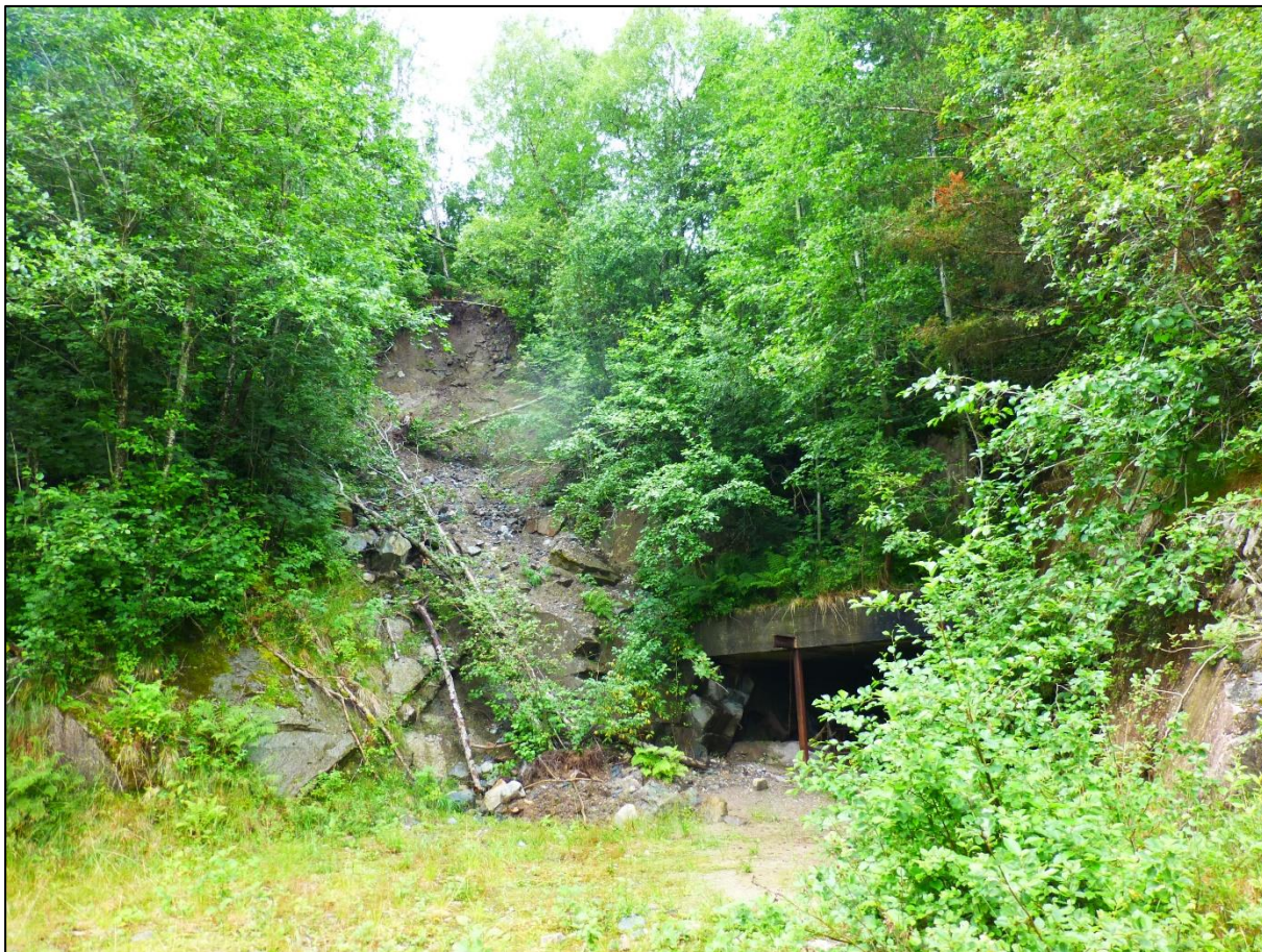
Figur 12: Bilde som viser gruveinngang og utrasing, mest sannsynlig som følge av undergraving av skråning.
